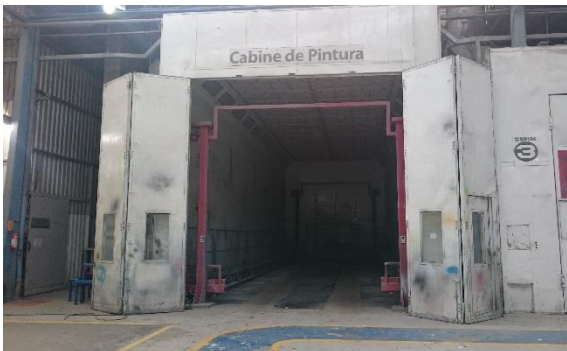
S/N - CABINE DE PINTURA E SECAGEM - PSA-108-E (FILTRO SECO) ASPERSUL
