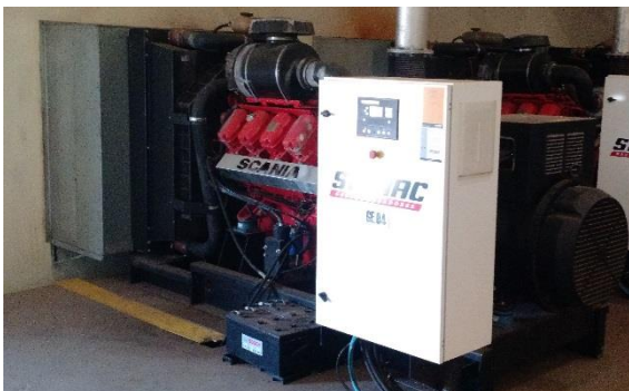
11104 - GERADOR 650 KVA – SCANIA STEMAC
